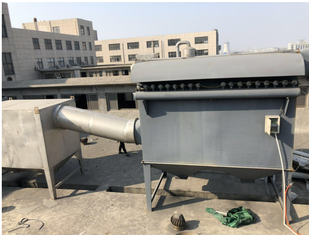
熔化废气处理装置现状（能力较小）
