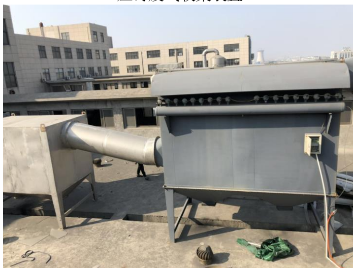
熔化废气处理装置
