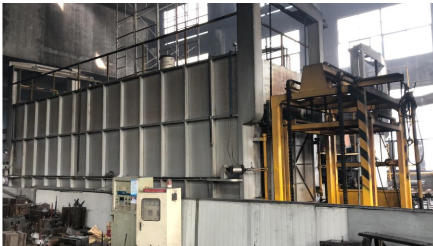
图 1-2 现场热处理设备
