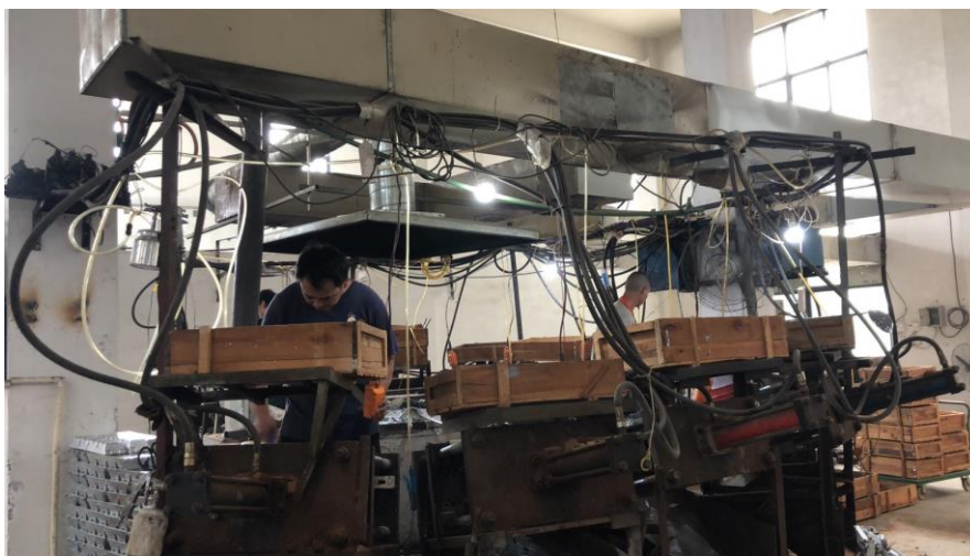
图 1-3 企业车间内线路较乱，废气未经有效收集
